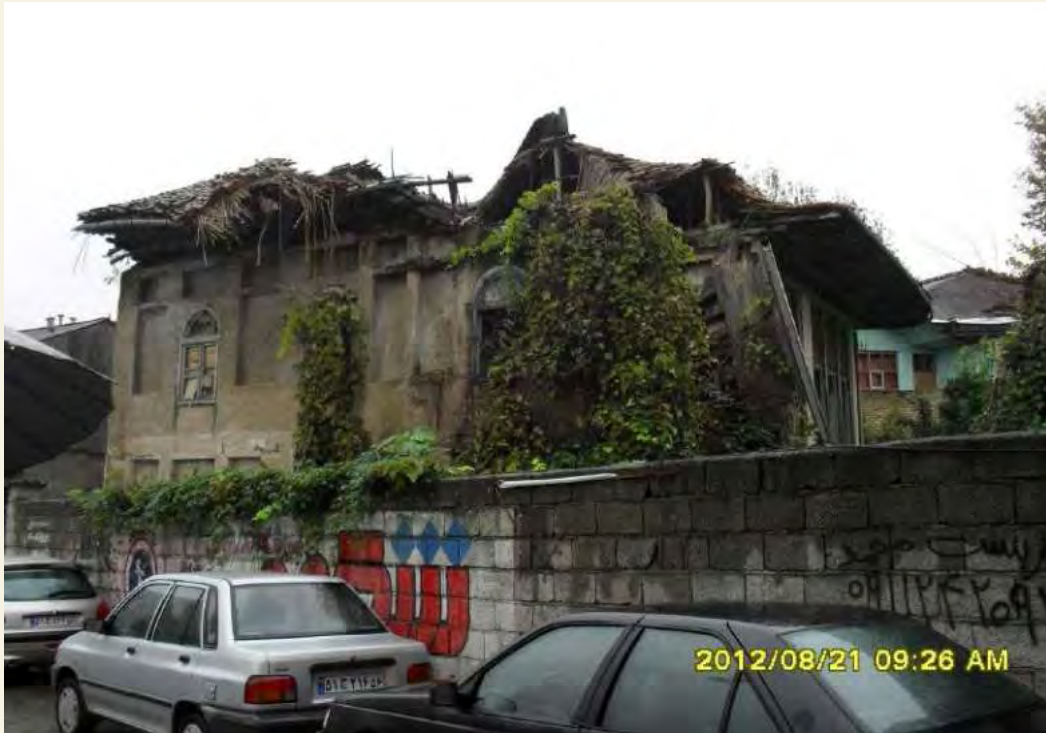
شکل ۳۷۰. پیش از تخریب کامل، ضلع جنوبی خانه بیش از هر ضلع دیگری دچار فرسایش و تخریب شده بود. البته در مقایسه با سایر اضلاع ساختمان، کمترین بازشوها نیز در همین ضلع تعبیه شده بود. منبع تصویر: (سرخیز و اسلامی، ۱۳۹۱)
